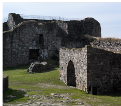
Upprustning och lagning av murverk på bland annat Bohus fästning och Varbergs fästning genomförs tack vare regeringens förstärkta anslag för bidragsfastigheter. Foto: Bert Leandersson
