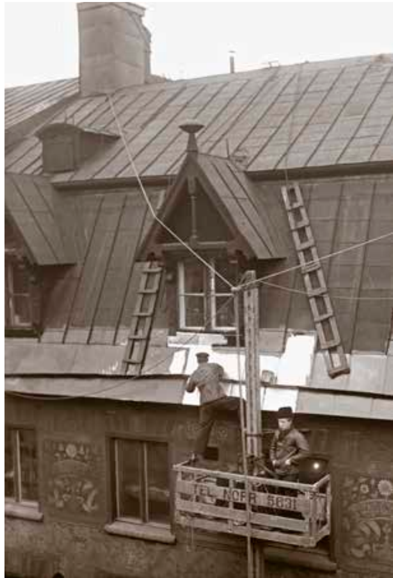
Takfoten är en utsatt del av ett plåttak, varför den oftast reparerats och bytts ut fler gånger är taket i övrigt. Foto: A. Malmström, Stockholms stadsmuseum.
