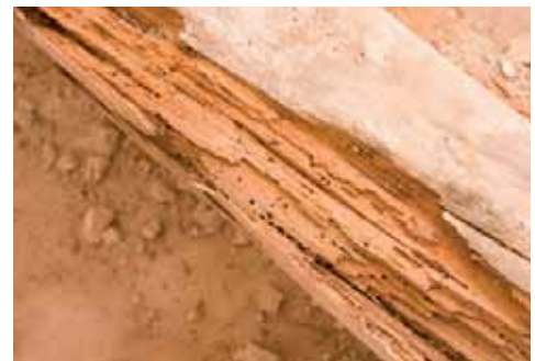
Träbjälkarna i muren är helt uppruttna av den innestängda fukten.
