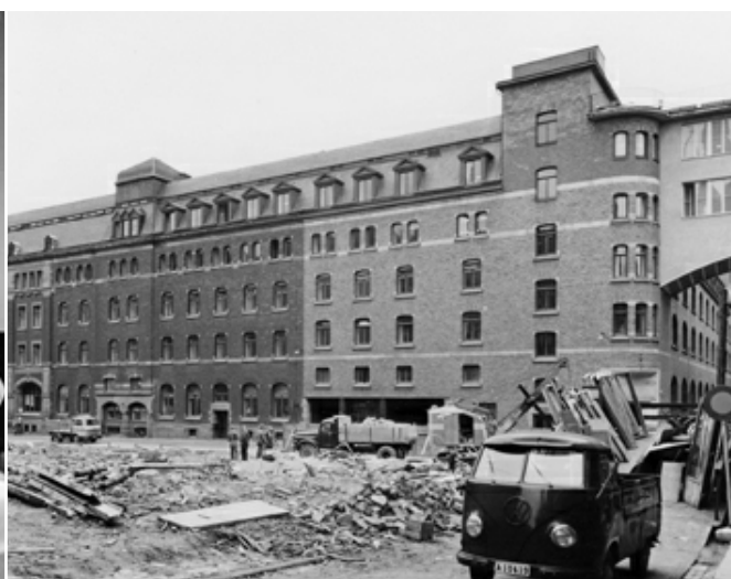
En bild från hösten 1960 har påpassligt fångat Centralposthusets hela fasad mot Mäster Samuelsgatan i samband med rivningen av grannkvarteret. Tillbyggnaden mot Klara Norra Kyrkogata från 1915 är utförd i enklare tegel men även den signerad Ferdinand Boberg.
